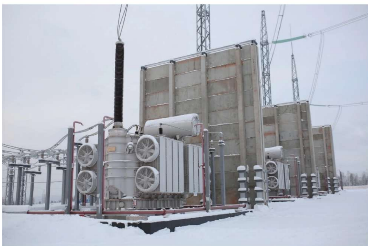
Иркутская область, Усть-Кут ПС 500 Усть-Кут
